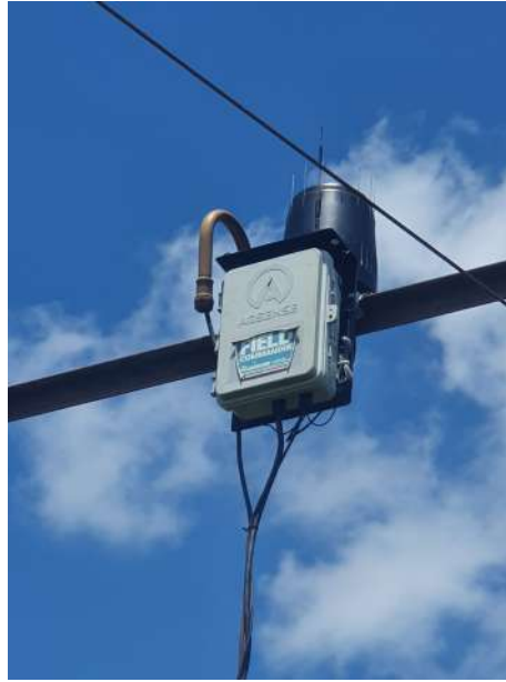
Figura 12 – Equipamento Field Commander instalado no pivô.
